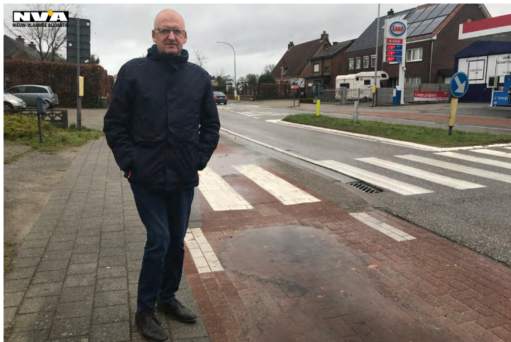
Foto: Schepen Herman Minnen staat aan het kruispunt met de Koolvenstraat waar de verzakking in de riolering goed merkbaar is.
