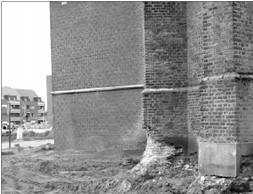
Ook de kerkmuur, ondertussen hersteld, kreeg een serieuze knauw.
